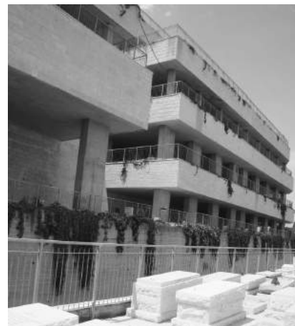
בניית קברים בארבע קומות. נראה כאילו מדובר בבית מגורים, או בחניון הנמצא באיזור מגורים.
